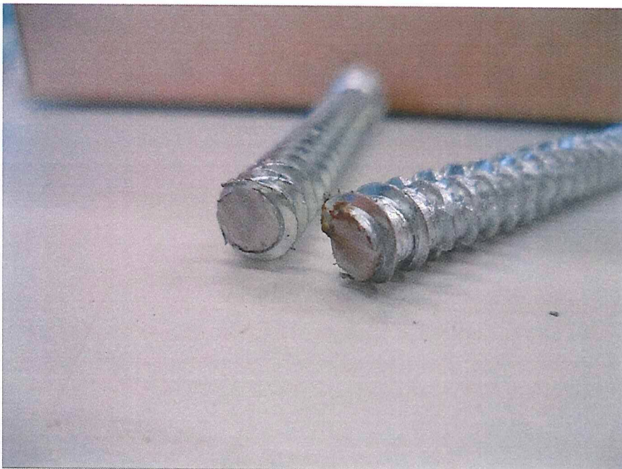
Abb. 3: Versagensbild eines abgescherten Rahmenankers
